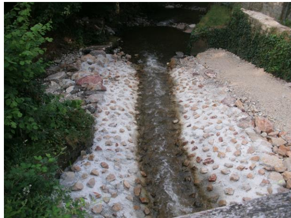
Aménagement d'une rampe en enrochement pour compenser la chute d'eau du Moulin
